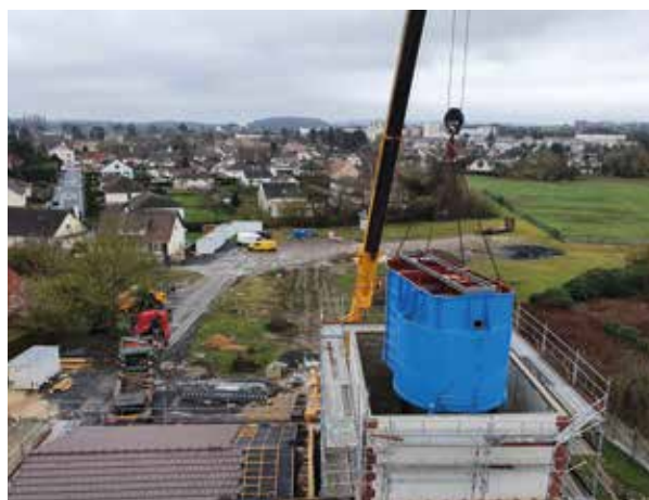
Vue sur le chantier, avec l'installation du densadeg. Cette pièce maîtresse de l'unité de décarbonatation élimine la dureté de l'eau avec un réacteur de recirculation des boues.
